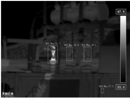
图 2 10 kV 电容器 I 组 671 本体套管接头发热红外图谱 Fig. 2 Infrared spectrum of bushing joint of 10 kV capacitor group I 671
